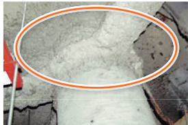
吹付け石綿 [レベル1]
